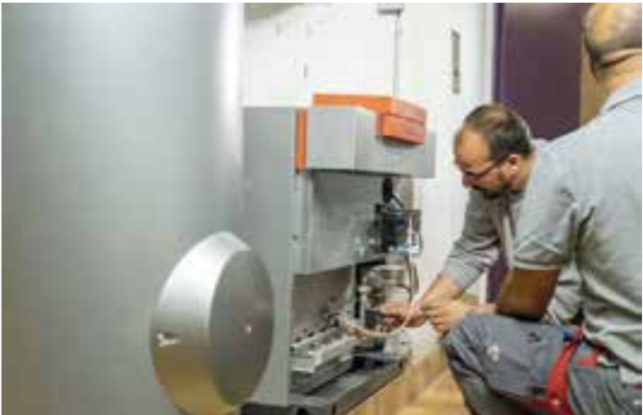
Zu den langfristigen Maßnahmen gehört eine Heizungsmodernisierung mit Einbindung erneuerbarer Energien. Foto: djd/ZVSHK
